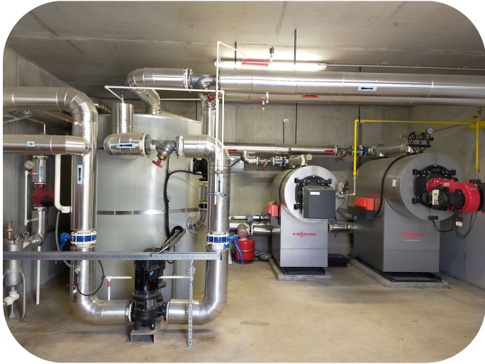
Local de chaufferie contenant la PAC et les 2 chaudières gaz
