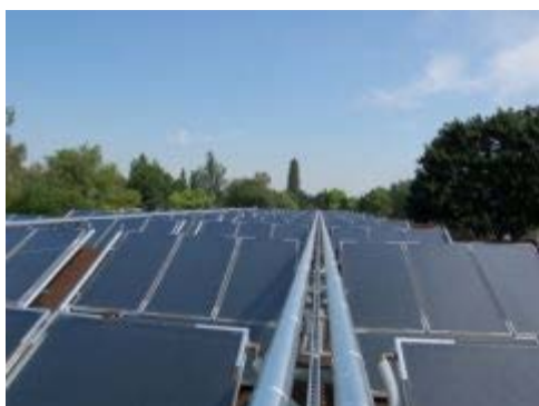
Les capteurs solaires
